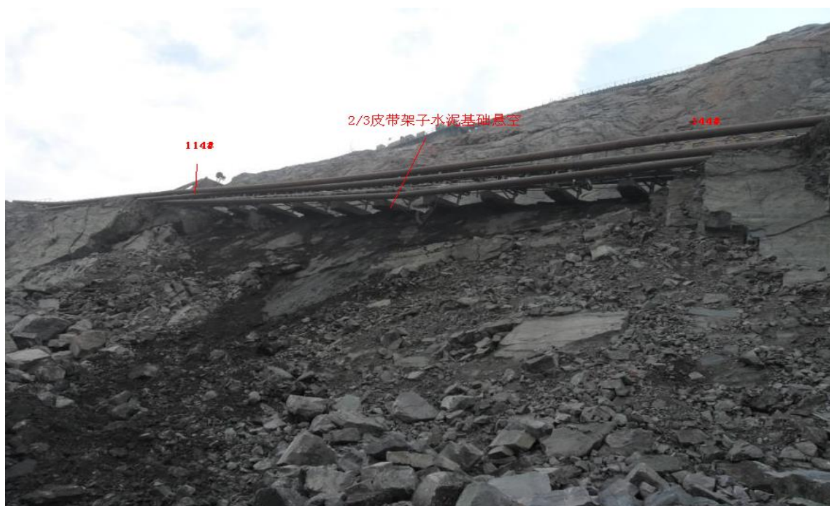
照片 3-5 K2 路基下方+10m~-35m 水平边坡滑坡体治理前（历史影像）
